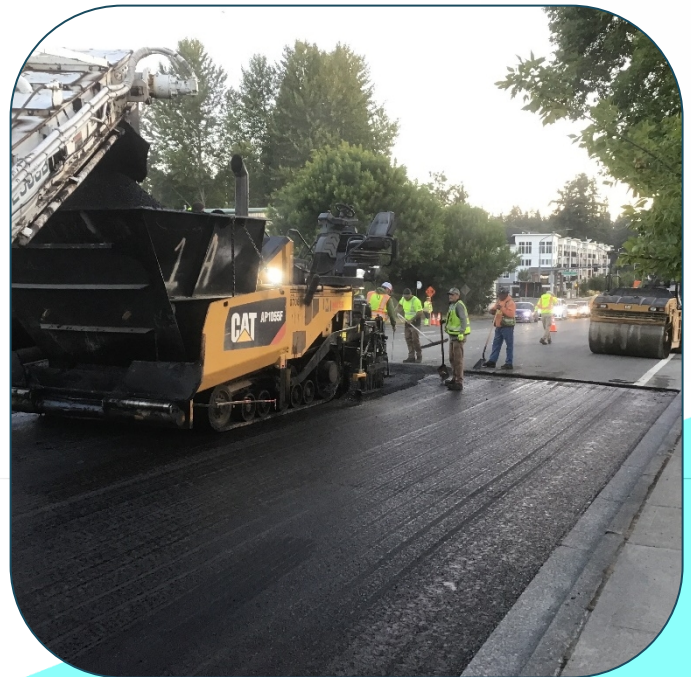
Fig. 5 Carpenter Rd. SE
