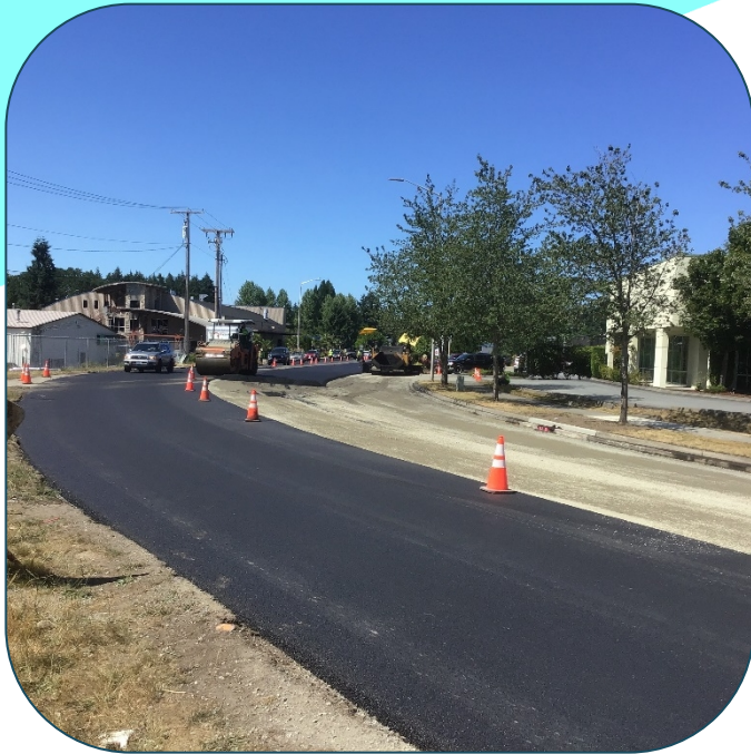
Fig. 6 Carpenter Rd. SE
